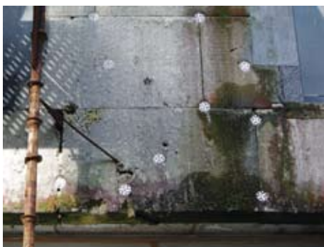
Фото 2. Внешний вид минеральной ваты на фасаде: плесень, оседание, влага; г. Санкт-Петербург
