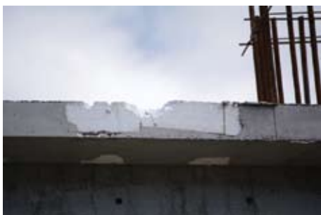
Фото 3. Разрушение обычного пенопласта; г. Санкт-Петербург
